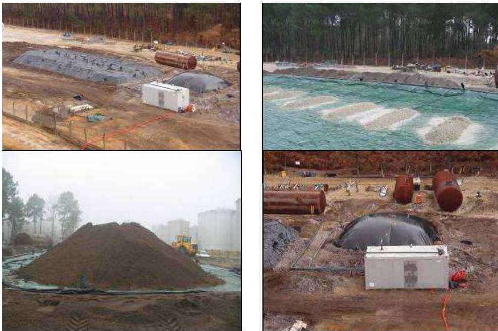
Exemple de réalisation VALGO.
