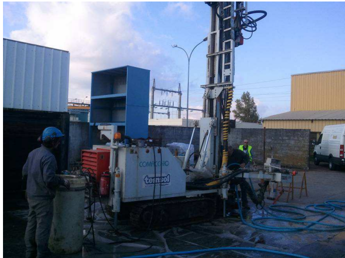
Atelier d'injection de réactifs
